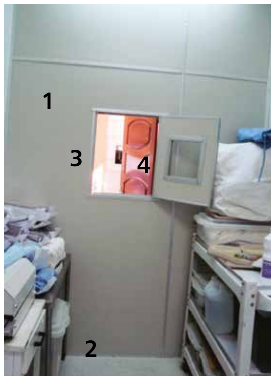
Figura 1. Barreira física (1) entre centro cirúrgico (2) e expurgo (3); janela de acesso (4)
